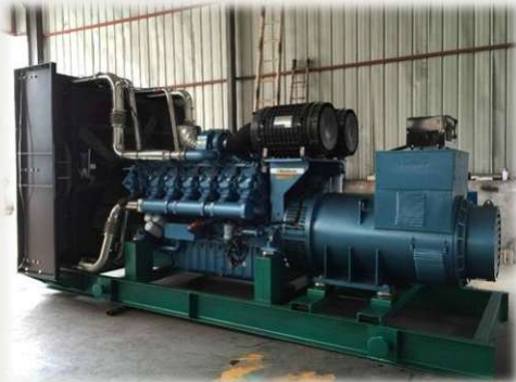
Когенераційна установка 1-2 МВт
