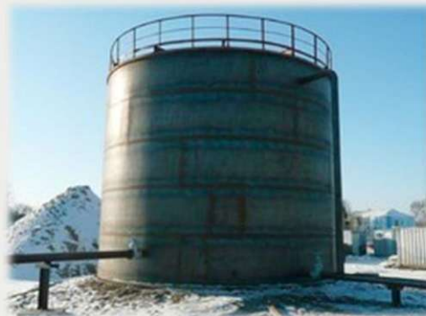
Бак термоакумулятор 100-200 м3
